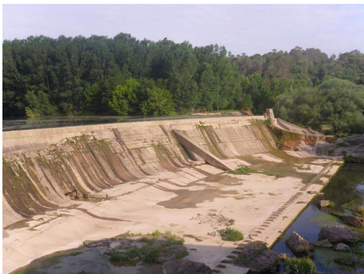
FIGURA 5. Resclosa situada al riu Fluvià, a Serinyà. En molts casos, aquestes infraestructures interrompen completament la continuïtat i la connectivitat fluvial i alteren el règim de cabals i la funcionalitat de l'ecosistema.
